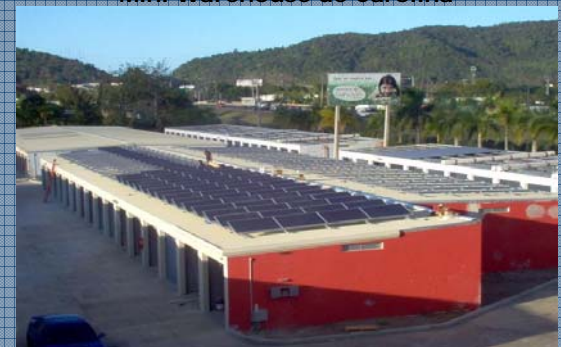
Paneles solares sobre techo de Mini Warehouse de Caguas
